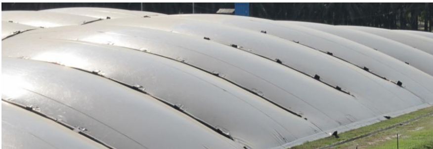
Captura y valorización del biogás en planta
